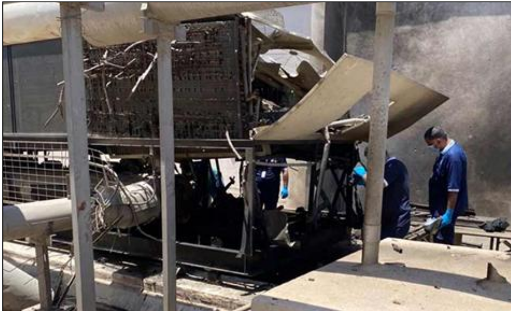
شکل ۸. انفجار دستگاه تهویه مطبوع روی بام؛ نمونه‌ای خطرناک از عدم محافظت یا محصور بودن تجهیزات بام در برابر حوادث برقی یا انفجار [۳۴]
