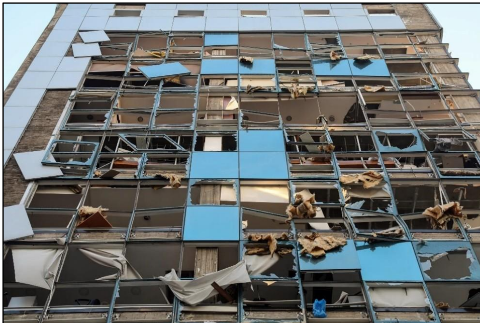
شکل ۱۲. نمای شیشه‌ای یک ساختمان پس از انفجار بیروت - مثالی واقعی از آسیب‌پذیری نماهای شیشه‌ای در مقابل موج انفجار و ضرورت استفاده از مصالح مقاوم [۳۷]
