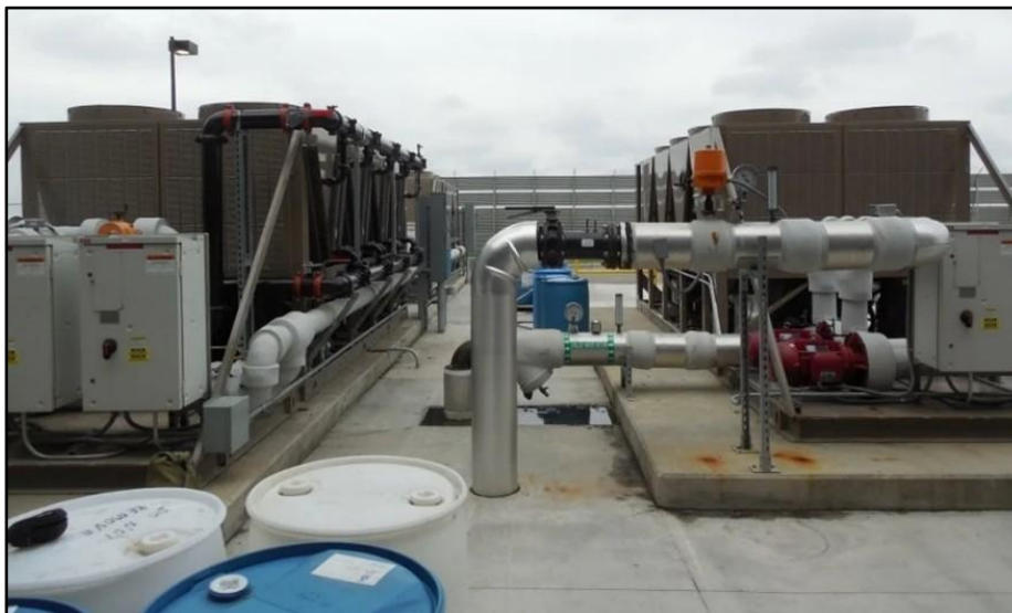
شکل ۱۵. تصویری از واحدهای تهویه روی بام که نزدیک لبه نصب شده‌اند [۳۹]
