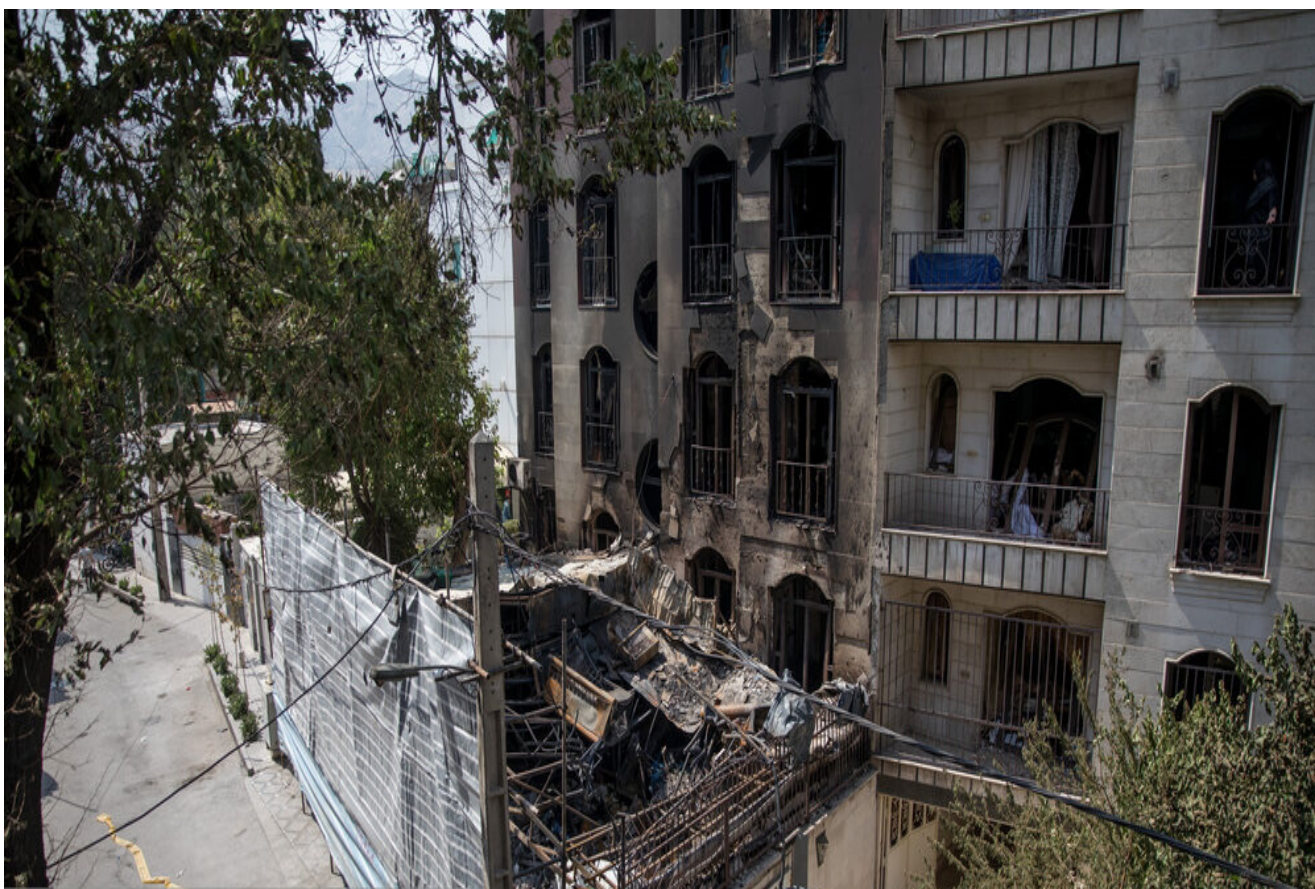
شکل ۲. ساختمان مرکز جراحی محدود سینامهر شمیران پس از انفجار و آتش‌سوزی
