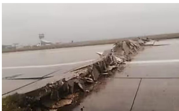
تخریب سطح باند فرودگاه هاتای
